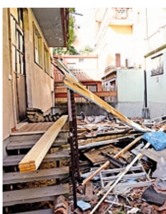
I danni all'edificio
